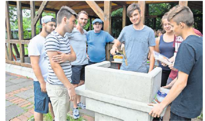
Der neue selbstgebaute Betongrill steht für die Zusammenarbeit der Marienberg- mit der Hildesheimer Walter-Gropius-Schule. FOTO: ALEXANDER RATHS
