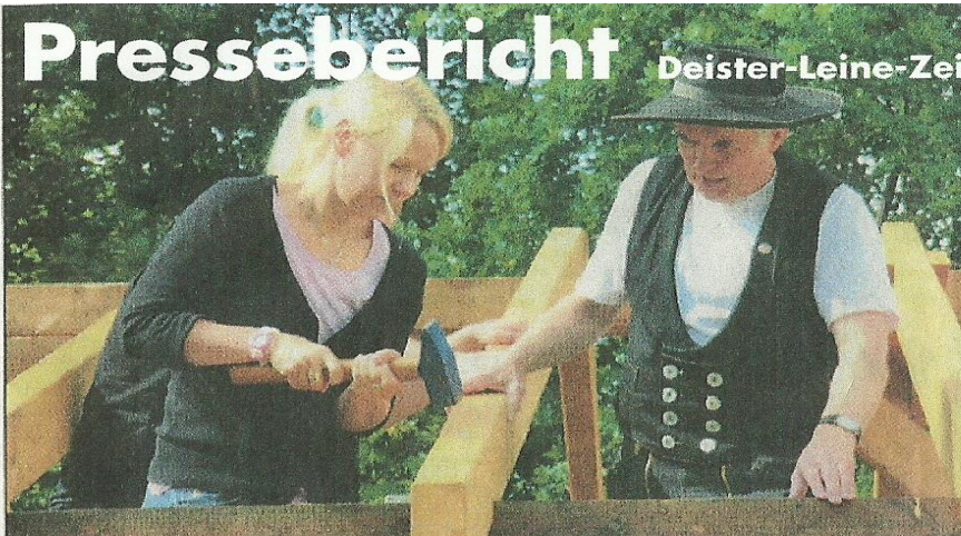
Schulleiterin Sylvia von Lindeiner schlägt mit der Hilfe von Zimmermeister Ingo Lübben den letzten Sparren Nagel in das Dachgerüst. ■ Fotos: Zimmer
