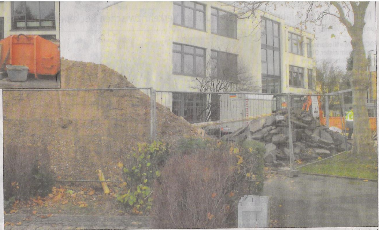
Baustelle auf dem Schulhof: Die Baumaßnahmen im Rahmen der Brandschutz-Generalüberholung an der Marienbergschule sind gut angelaufen. Zunächst wird die neue Fluchttreppe errichtet. ■ Fotos: Ehlers
